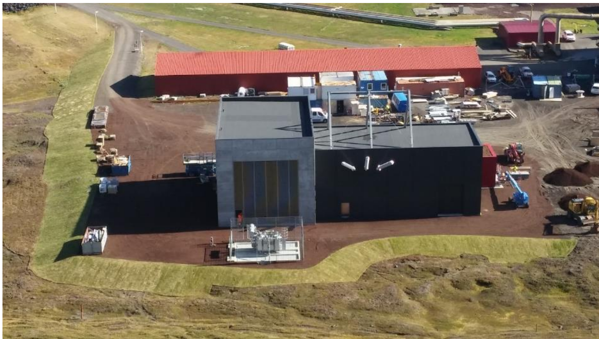
MYND 4-1 Nýja 220 kV tengivirkið við Kröflustöð. Inntak Kröflulínu 4 í stálramma á þaki. Nýtt tengivirki á Hólasandi og viðbót við tengivirkið á Rangárvöllum gætu lítið svipað út.
