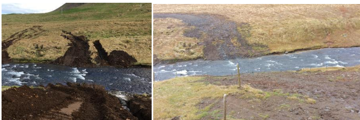
MYND 4-24 Dæmi um árpverun Fossár við Ólafsvík á Snæfellsnesi. Fyrri myndin er tekin í maílok 2017 þegar nýbúið er að leggja rör í árbotinn, en seinni myndin í byrjun nóvember 2017. Hún sýnir frágang eftir að 66 kV strengur hefur verið lagður og búið að slétta yfirborð, en 220 kV strenglöggn er talsvert umfangsmeiri.
