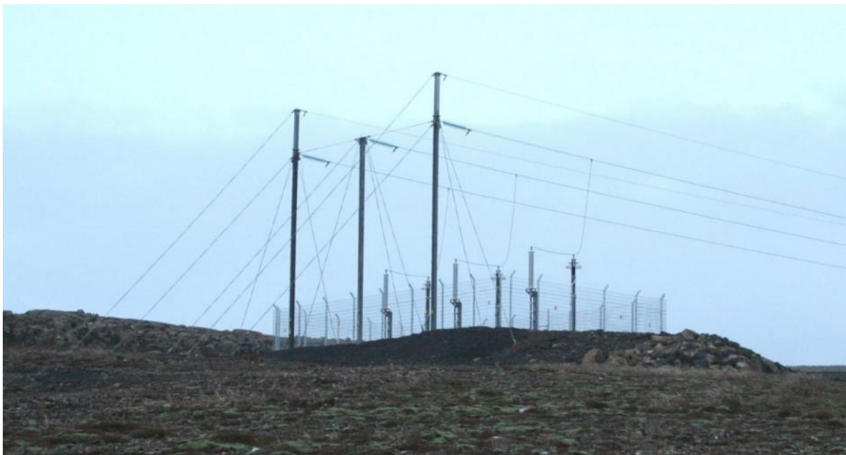
MYND 4-3 Endavirki fyrir 132 kV jarðstreng (eitt strengjasett) í Hnoðraholtslínu 1. Efst eru jarðvírar til að verjast eldingum. Endavirkin í Hólasandslínu 3 verða talsvert umfangsmeiri, þar sem um er að ræða 220 kV jarðstreng.
