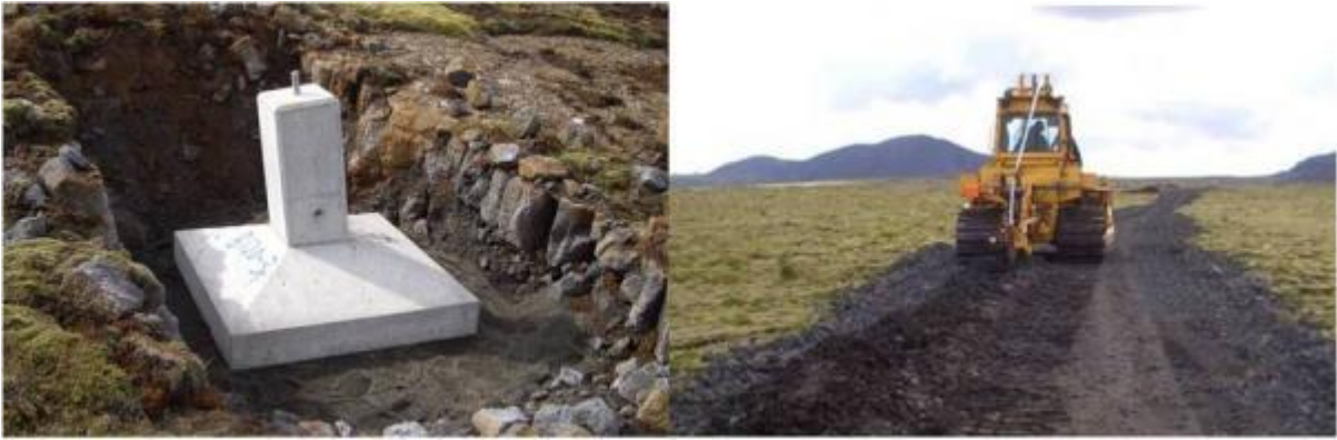
MYND 4-8 Til vinstri má sjá forsteypta undirstöðu M-masturs og til hægri sést hvernig jarðskaut er plægt í kant á vegslóð.
